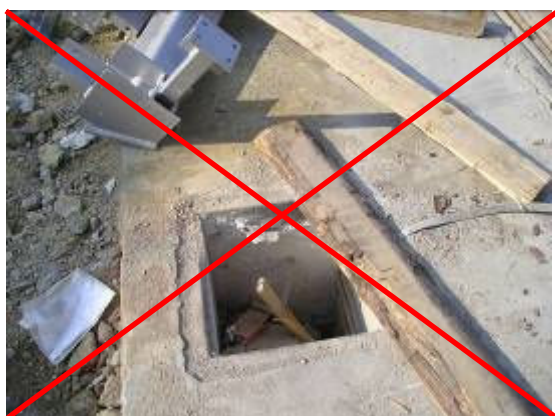
Slika: Vse talne odprtine je potrebno ograditi ali prekriti.
